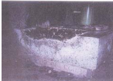
DAÑO CAUSADO POR ELFUEGO EN HORMIGÓN SIN REFUERZO – 108 mm de exfoliación
