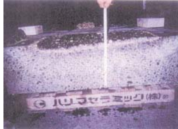
DAÑO CAUSADO POR ELFUEGO EN HORMIGÓN CON FIBRA SINTÉTICA – 36 mm de exfoliación
