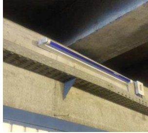
Luz UV instalada en túnel
