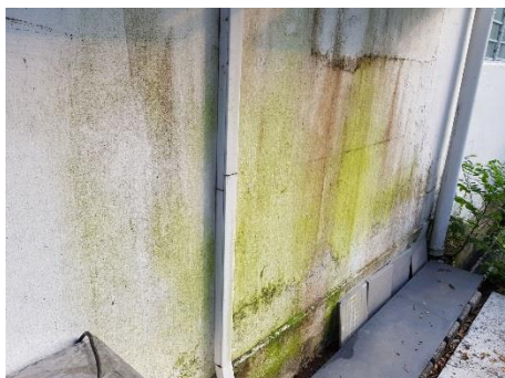
Pared sin tratamiento afectada por suciedad y moho.
